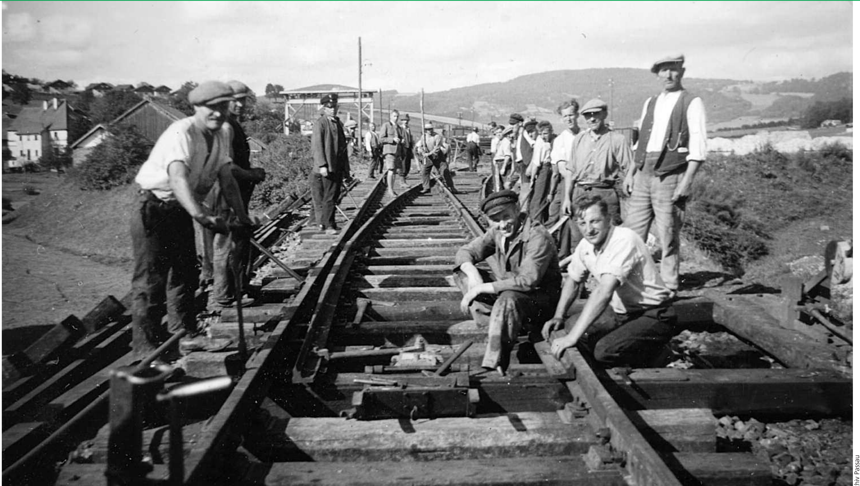
Gleisbauarbeiten vor dem Hauzenberger Bahnhof durch die Firma Stadler aus Bärnbach. Im Hintergrund ein Portalkran zur Verladung von Granit.
